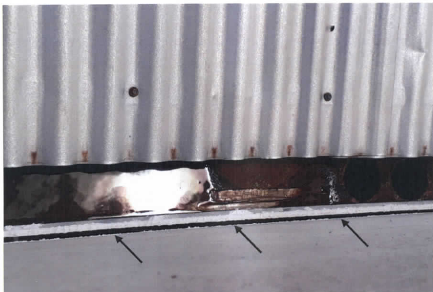
Foto 31 – Desprendimento da calha em relação a platibanda Data: 24 de janeiro de 2017
