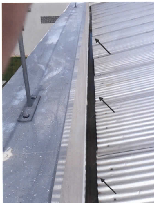
Foto 34 – Acumulo de água da chuva na calha Data: 24 de janeiro de 2017
