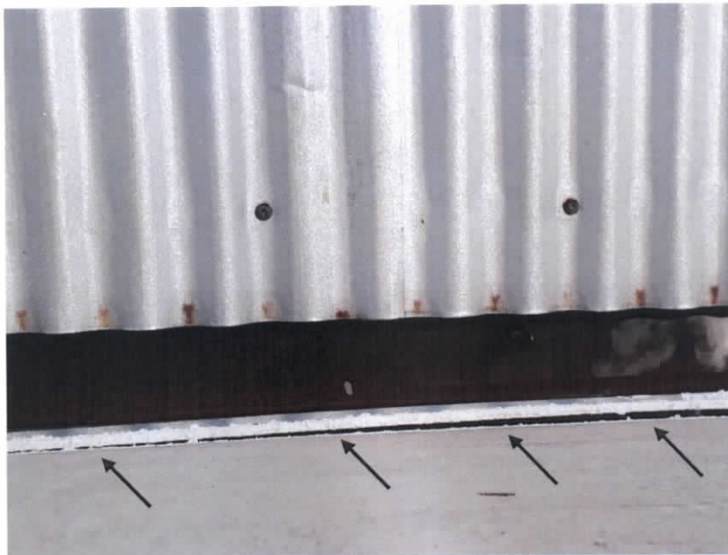
Foto 33 – Desprendimento da calha em relação a platibanda Data: 24 de janeiro de 2017
