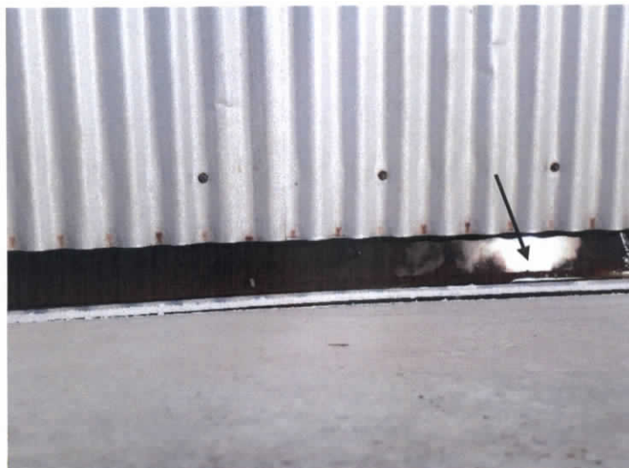
Foto 32 – Acumulo de água da chuva na calha Data: 24 de janeiro de 2017
