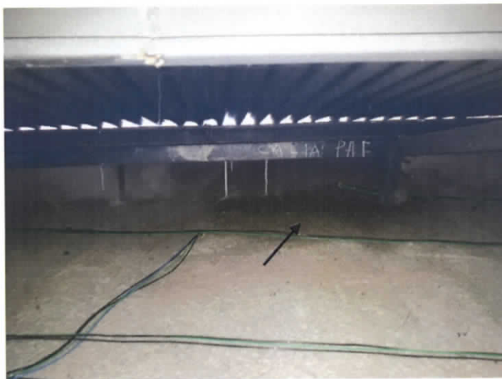
Foto 20 – Vazamento/transbordo água da calha Data: 24 de janeiro de 2017
