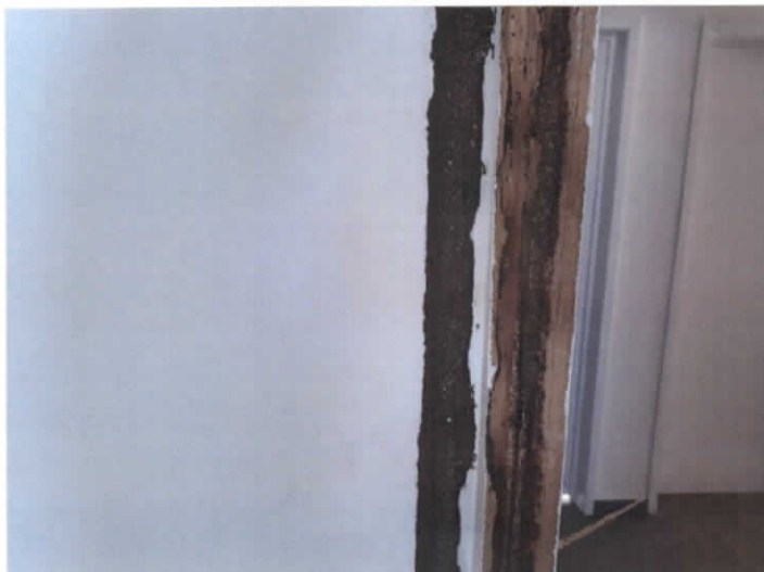
Foto 41 – Presença de cupins no alisar Data: 24 de janeiro de 2017
