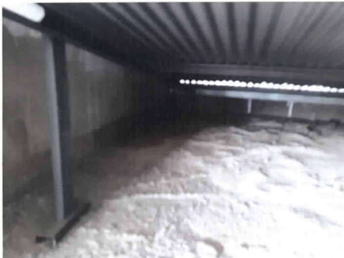
Foto 25 – Vazamento/transbordo água da calha Data: 24 de janeiro de 2017
