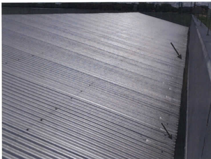
Foto 29 – Acumulo de água da chuva na calha Data: 24 de janeiro de 2017
