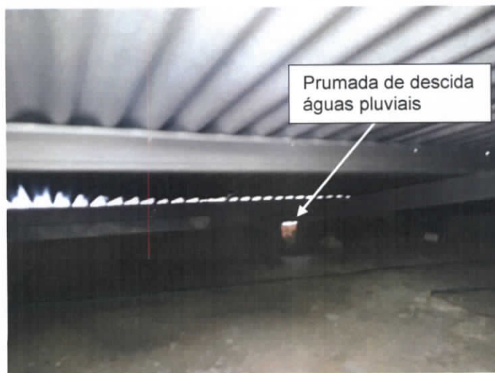
Foto 24 – Vazamento/transbordo água da calha Data: 24 de janeiro de 2017
