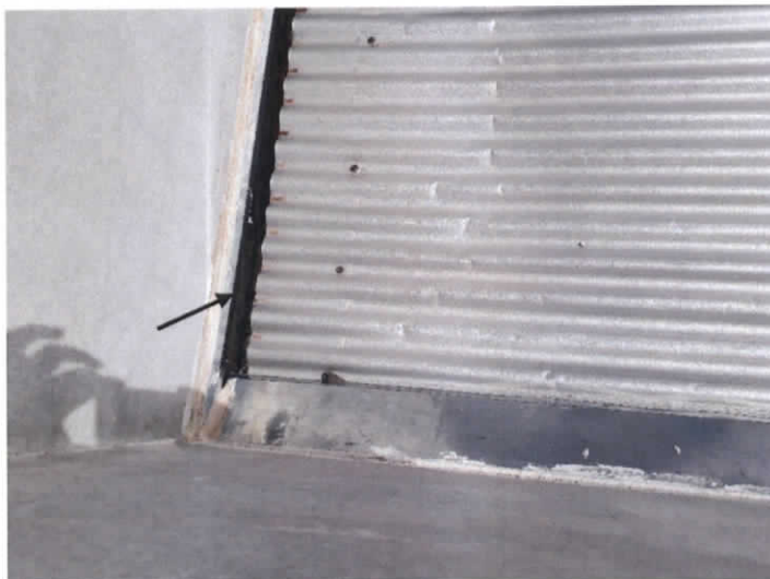
Foto 27 – Acumulo de água da chuva na calha Data: 24 de janeiro de 2017
