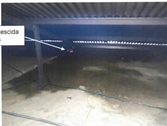
Foto 22 – Vazamento/transbordo água da calha Data: 24 de janeiro de 2017
