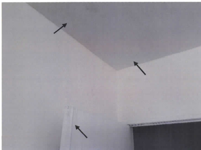
Foto 11 – Sala Observação Pediátrica (det. porta de madeira) Data: 24 de janeiro de 2017
