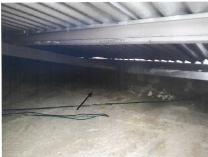
Foto 21 – Vazamento/transbordo água da calha Data: 24 de janeiro de 2017
