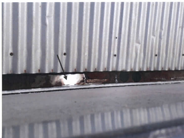
Foto 30 – Acumulo de água da chuva na calha Data: 24 de janeiro de 2017
