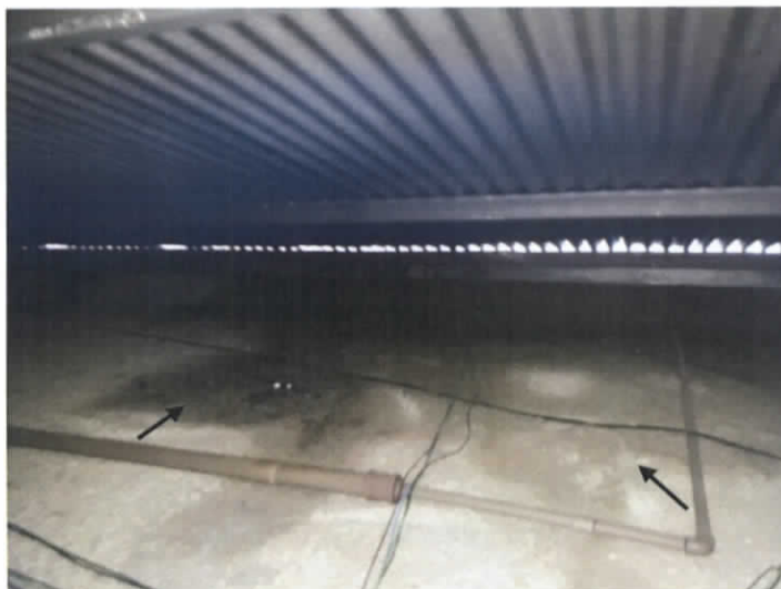
Foto 23 – Vazamento/transbordo água da calha Data: 24 de janeiro de 2017
