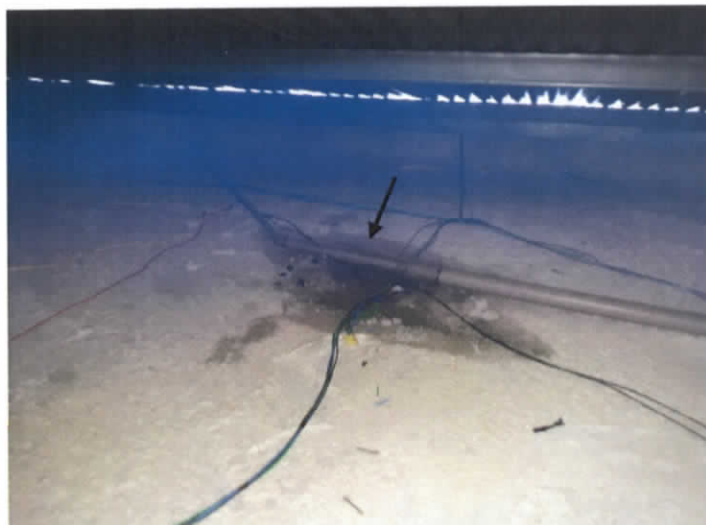
Foto 19 – Vazamento de água tubulação hidráulica Data: 24 de janeiro de 2017
